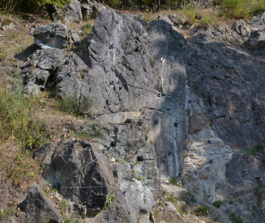
Skalní blok zpevněný vazbou ocelovými lany a podpůrnou zídka. Foto Pavel Jaška.
