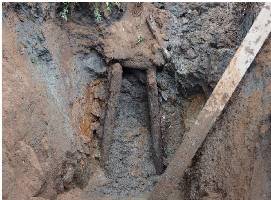
Obr. 6: Detail páru výdřevy portálu štoly Barbora při zahloubení cca 2 m. Foto Martin Šefrna.
